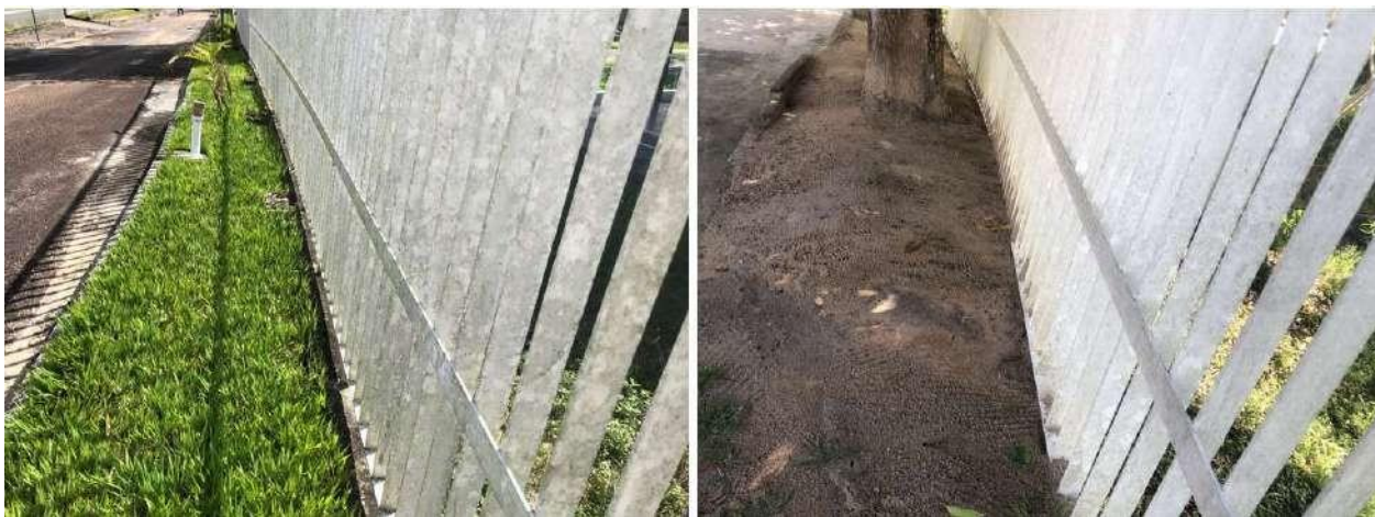
Figura 10 - Deformação do Muro existente
