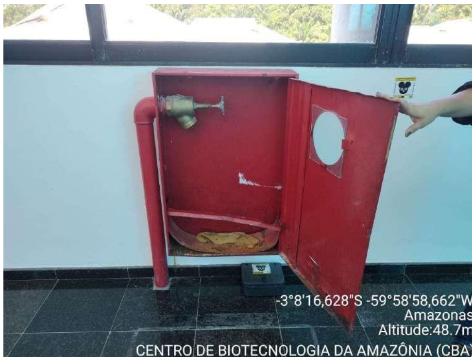
Figura 26- Caixa de Hidrante sem funcionamento, ausência de mangueira de incêndio.
