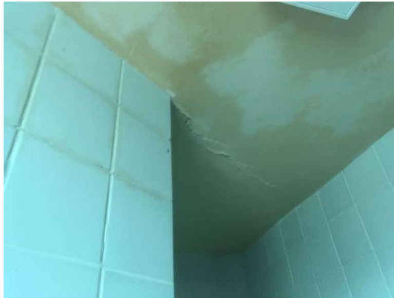
Figura 7 -Formação de trinca na Laje do Refeitório
