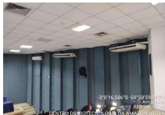
Foto 20- Parede grave infiltração
