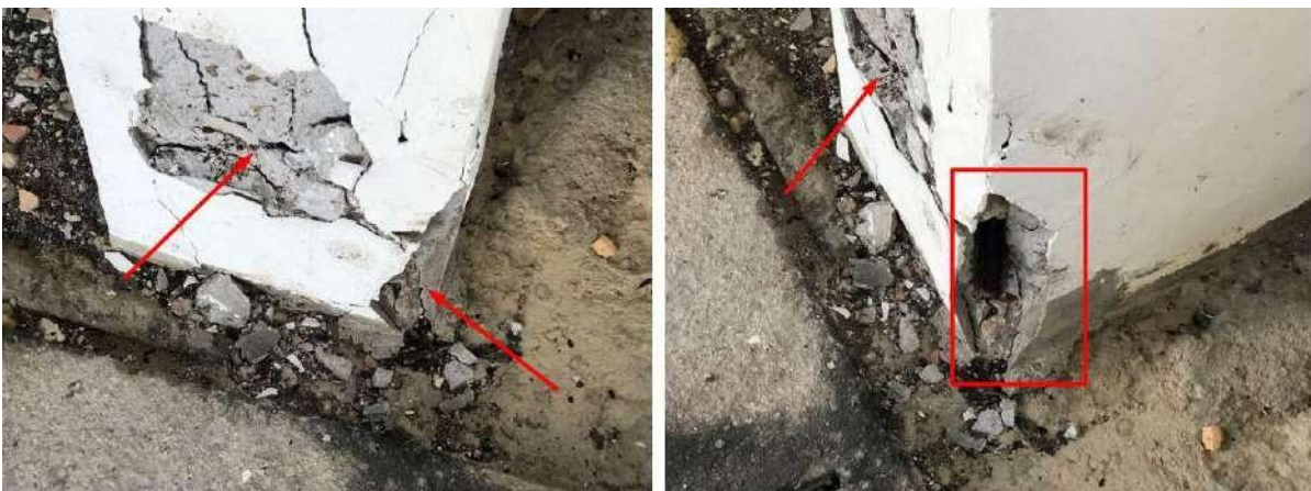
Figura 6 - Destacamento do concreto nos Pilares
