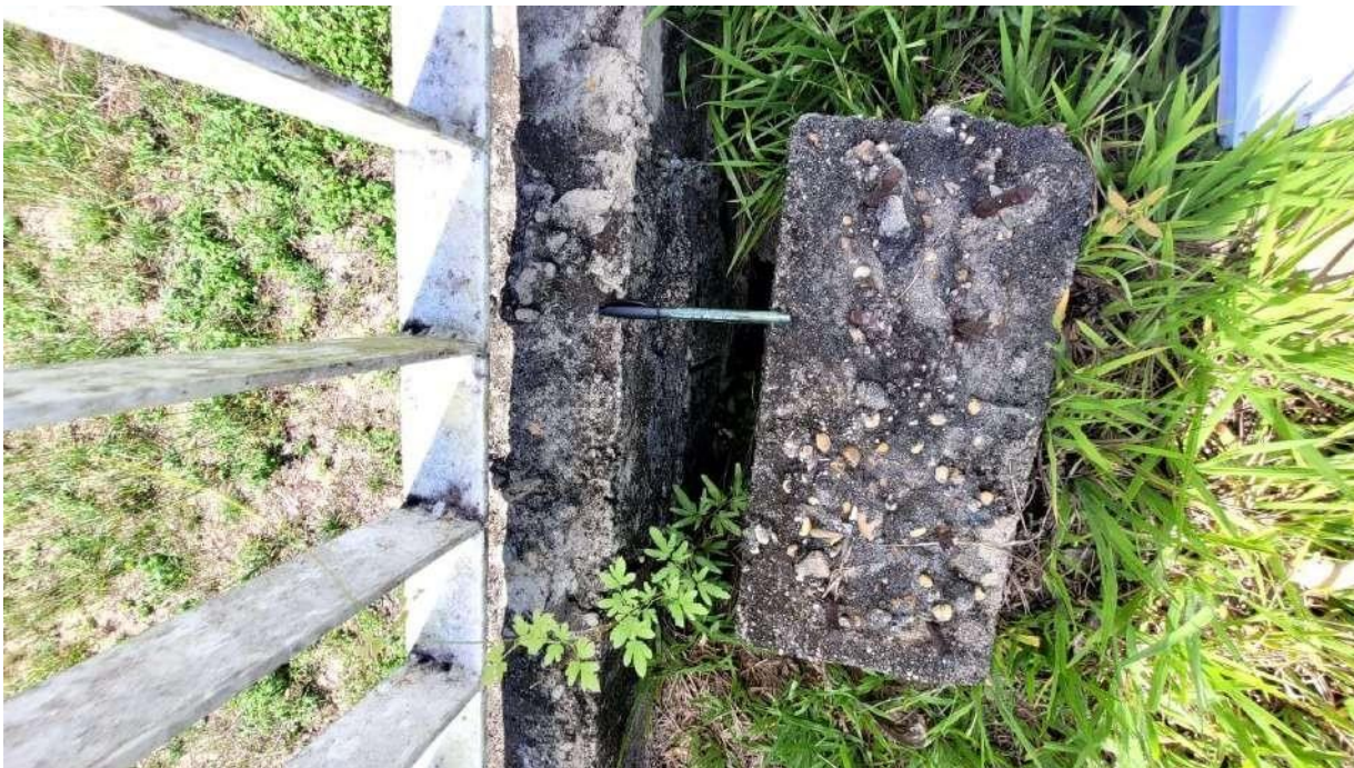
Figura 12- Detalhe do muro de contenção, aproximadamente 12 cm de deslocamento.
