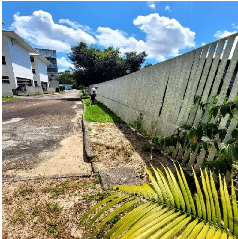
Figura 13- Detalhe do gradil e muro de contenção com grande inclinação. É necessário recuperação estrutural com urgência.
