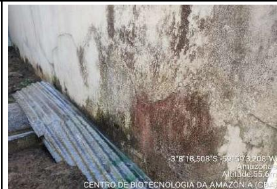
Foto 14- Parede grave infiltração
