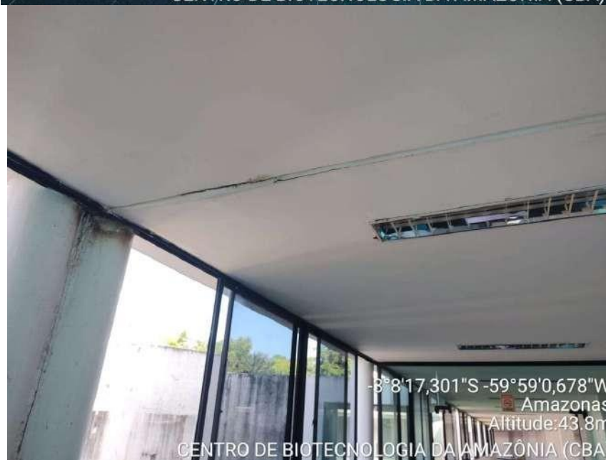
Figuras 20 e 21- Detalhe da infiltração de esquadrias.
