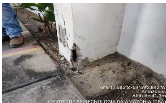
Foto 17- Dano estrutural no pilar
