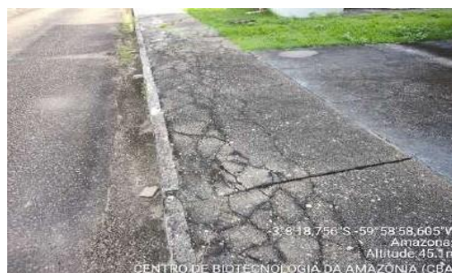
Foto 18- Pavimento externo danificado
