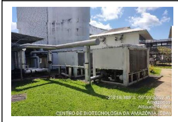
Foto 25- Centrais de ar condicionado sem funcionamento
