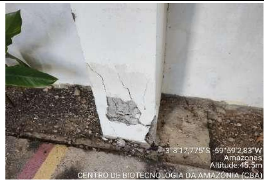
Foto 16- Dano estrutural no pilar
