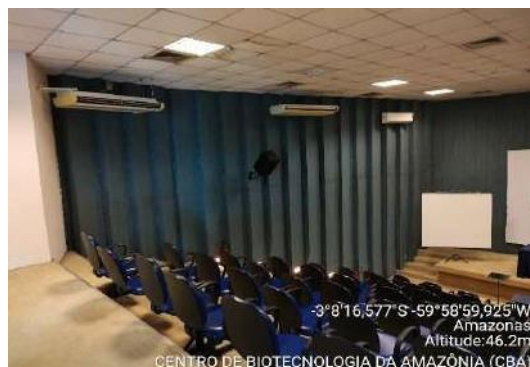
Foto - 19- Forro danificado por infiltrações
