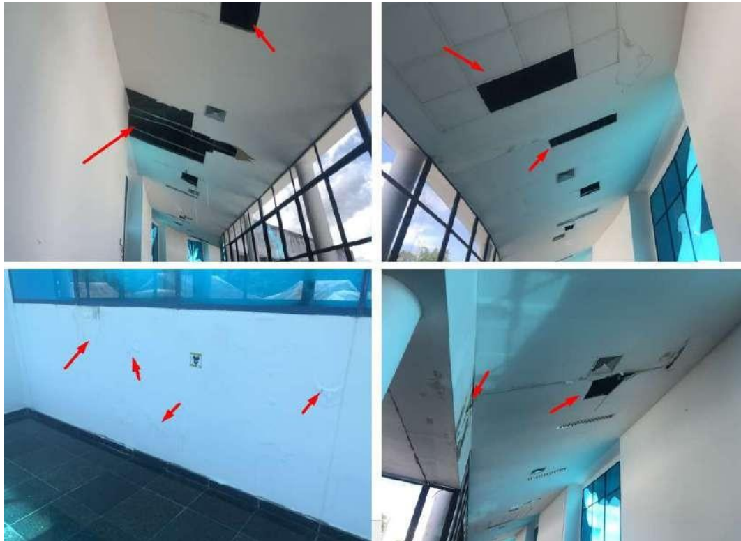
Figura 8 - Deterioração do Forro e formação de bolores (Local: Showroom)
