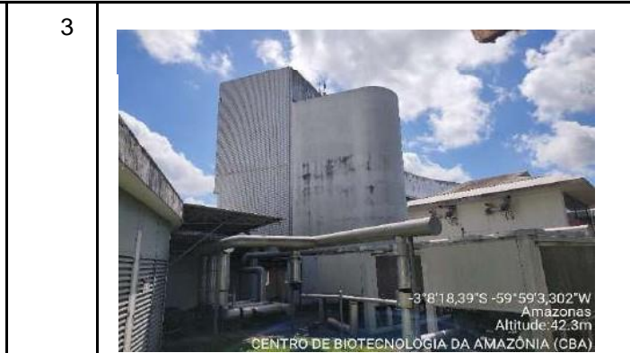
Foto 26- Centrais de ar condicionado sem funcionamento
