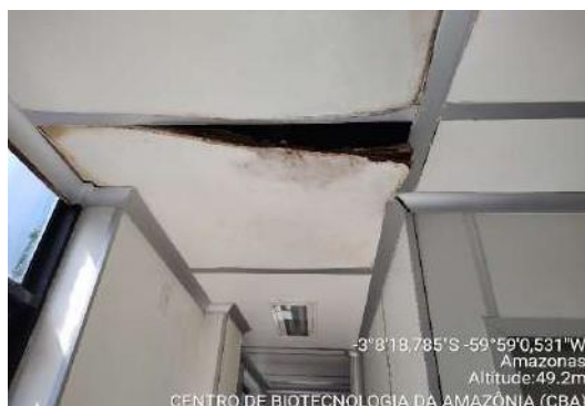
Foto 21- Forro bastante danificado por infiltrações
