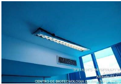
Foto 05- Forro e lumináriaas danificadas
