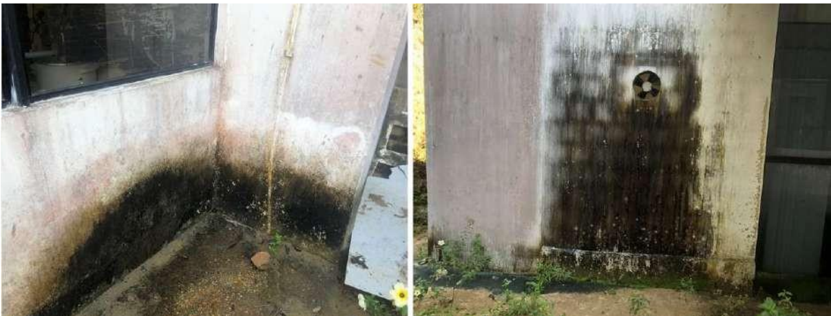
Figura 15 - Drenagem ineficiente (local: Deposito de drogas)
