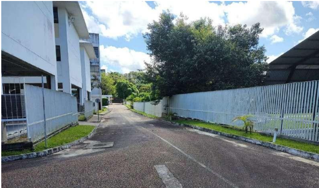
Figura 11- Muro e gradil limítrofe, apresentando grande recalque em sua base.
