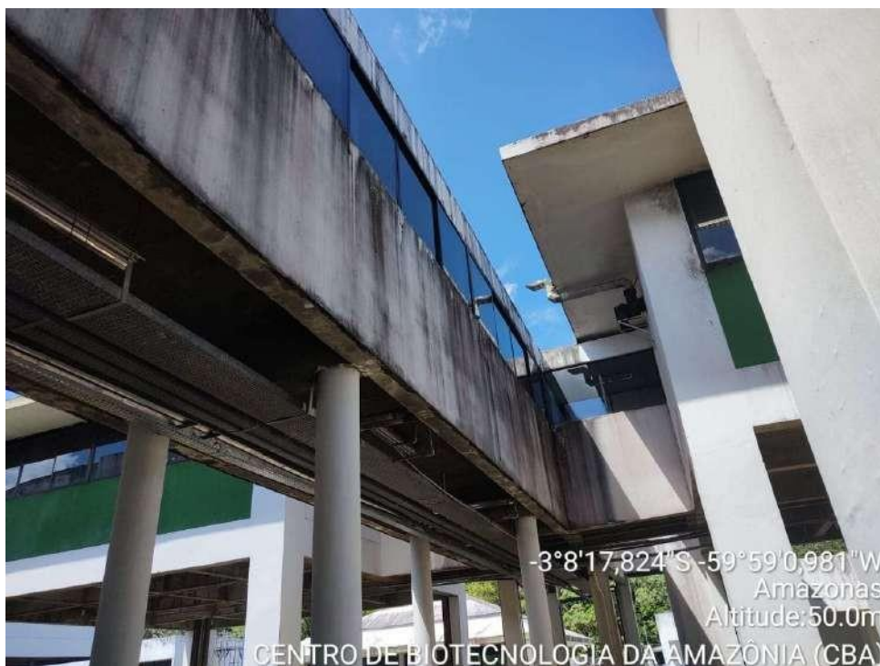
Figuras 22 e 23- É possível observar que a infiltração nas esquadrias é generalizado em todas edificações do complexo.
