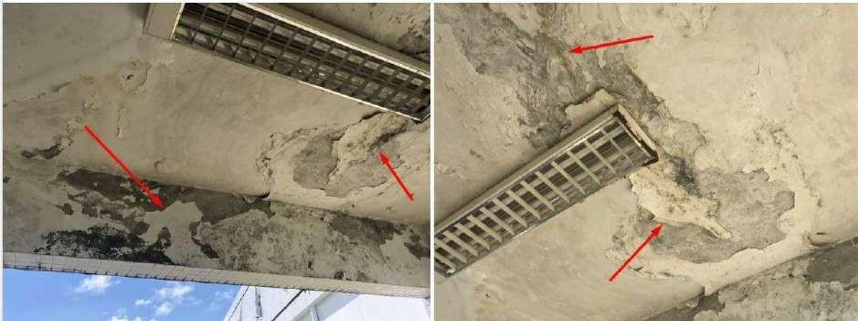
Figura 5 - Infiltração nos elementos estruturais (Local: Entre o Alojamento e Passarela Principal)
