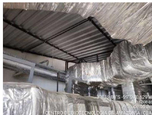
Foto 24- Paredes mofadas, ambiente bastante insalubre
