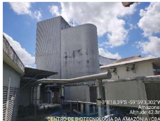
Foto 26- Centrais de ar condicionado sem funcionamento
