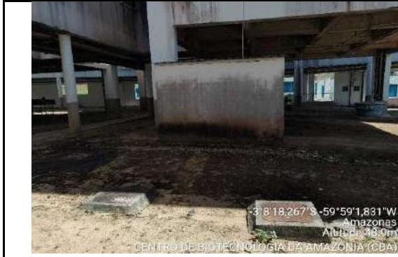
Foto - 13- Terreno sofrendo assoreamento, paredes extremamente danificadas com infiltrações
