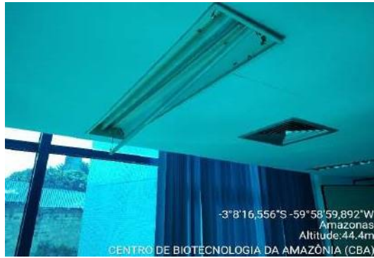
Foto 03 - Luminárias danificadas, sistema de refrigeração sem funcionamento
